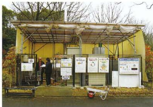
公園内木質バイオマス有効活用システム実証試験で使用されている施設。この中で、薪ボイラーとスターリングエンジンが稼働している
